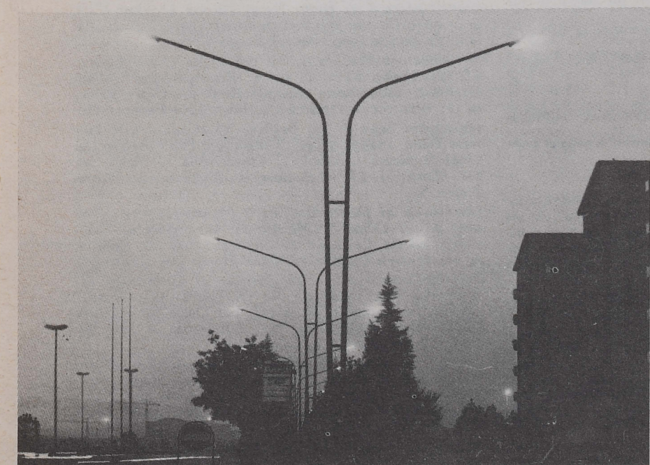
Tra gli altri impianti recentemente realizzati c'è quello di via Sansovino.
