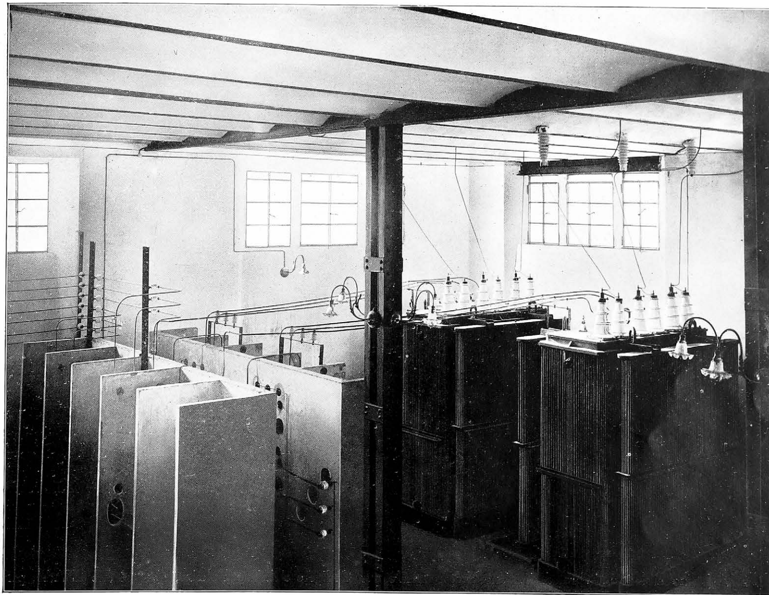
Ferrara - Interno della Cabina di trasformazione della Società Adriatica di Elettricità.
