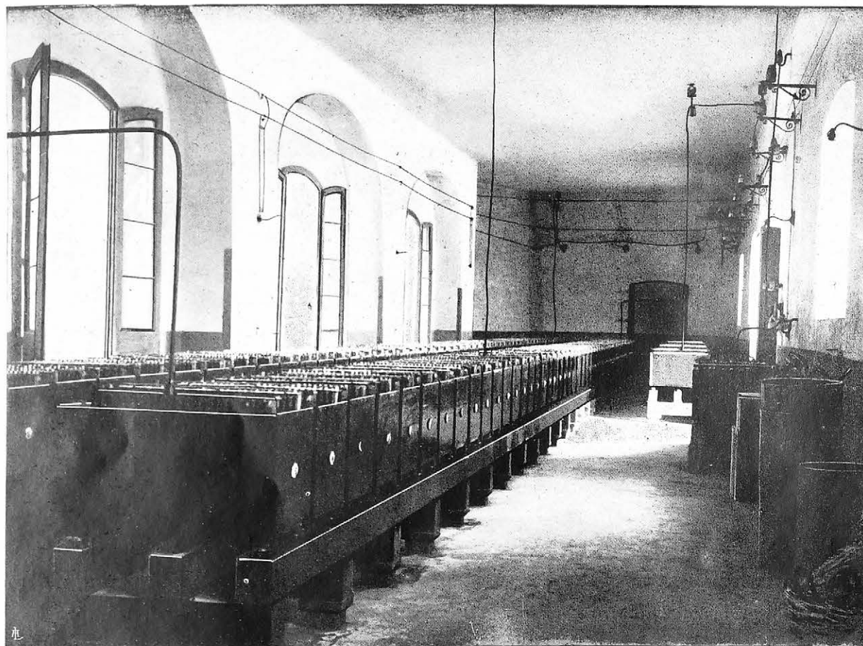
Tipo di una batteria di accumulatori degli impianti Pugliesi.
